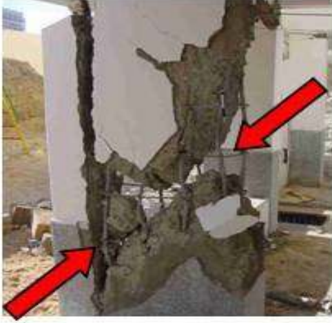
Resim 1. Kolonlardaki çapraz çatlaklar, binaların dikey yük taşıma kapasitesini tehlikeye sokmaktadır. [1]
